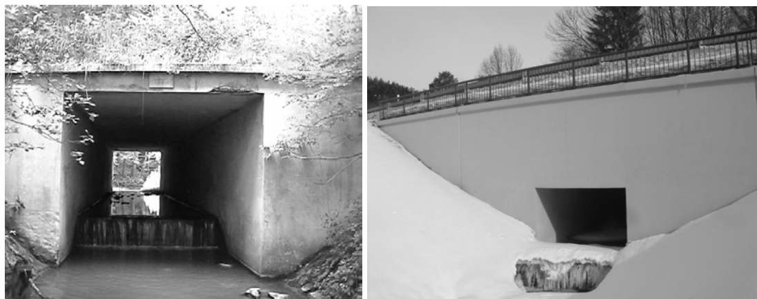
Obr. 3: Původně stavebně špatně řešený objekt u obce Stupava před a po rekonstrukci silnice I/50, která jeho rozměry ještě více zmenšila
