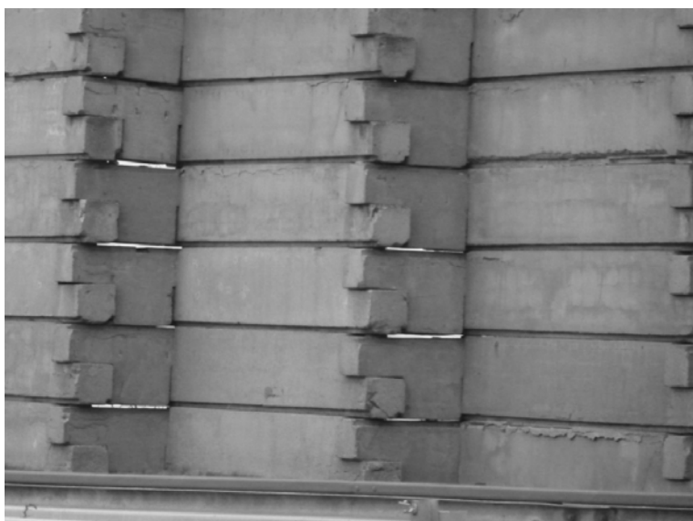
Obr. 1: Pohled na stěnu s patrnými spárami
